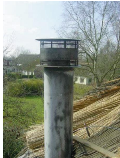
De foto van de vonkenvanger laat een verouderd gegalvaniseerd kanaal zien. Dit kanaal mondt duidelijk op een verkeerd gebied uit. Het uitmonden op deze plaats dicht naast het riet is nooit toegestaan en brandgevaarlijk. Ze komt ook niet overeen met de plek van de uitmonding die hierboven is geschreven.
